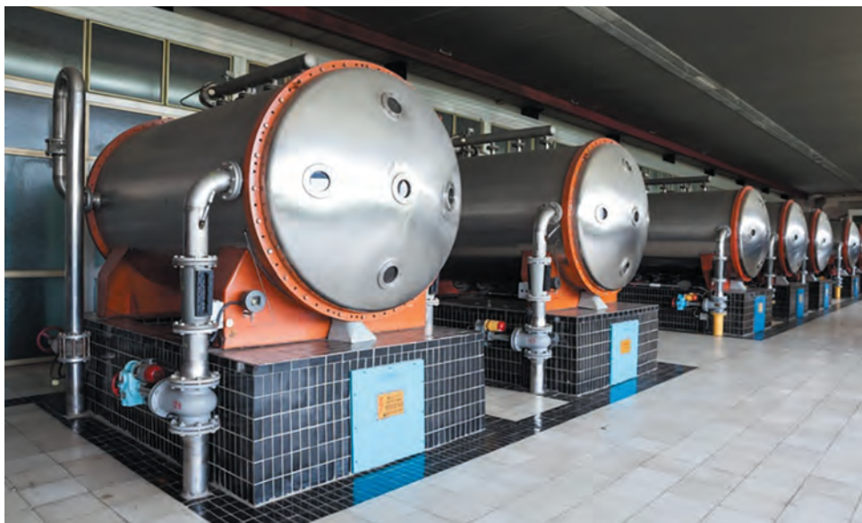
Рис. 26. Генераторы озона на Восточной станции водоподготовки в Москве
