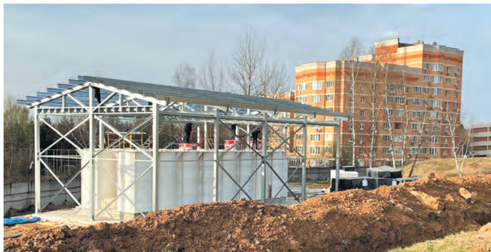
Рис. 66. Внешний вид установки водоподготовки с использованием технологии «Аэромаг»
