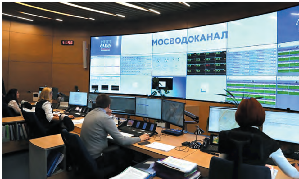
Рис. 34. Центральное диспетчерское управление Мосводоканала
