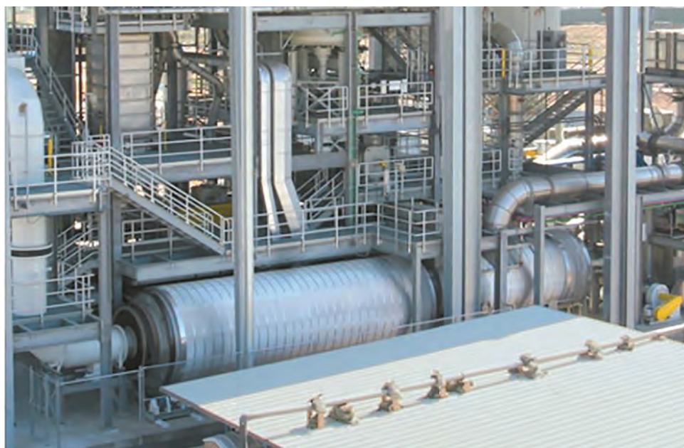
Рис. 65. Термическая сушка осадков сточных вод
