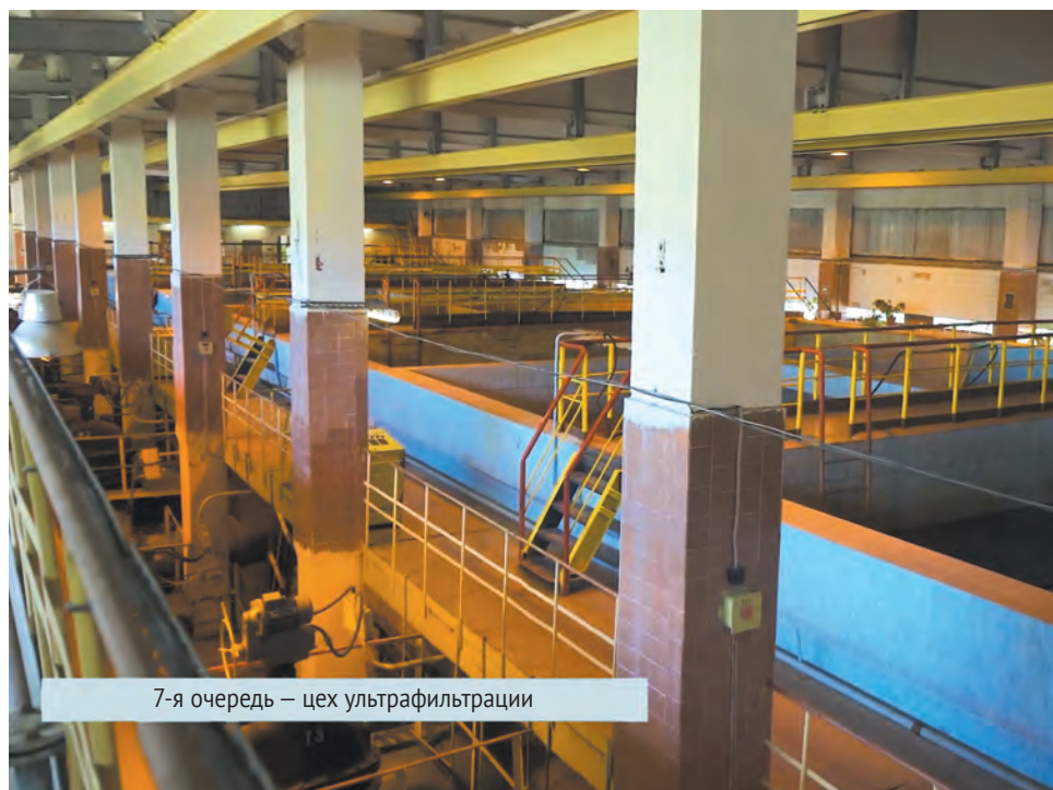
Рис. 30. Западная фильтровальная станция в Екатеринбурге с технологией ультрафильтрации промывной воды. Источник: МУП «Водоканал», Екатеринбург
