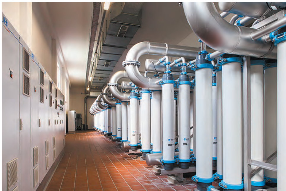
Рис. 29. Ультрафильтрационные мембраны на Юго-Западной станции водоподготовки Москвы
